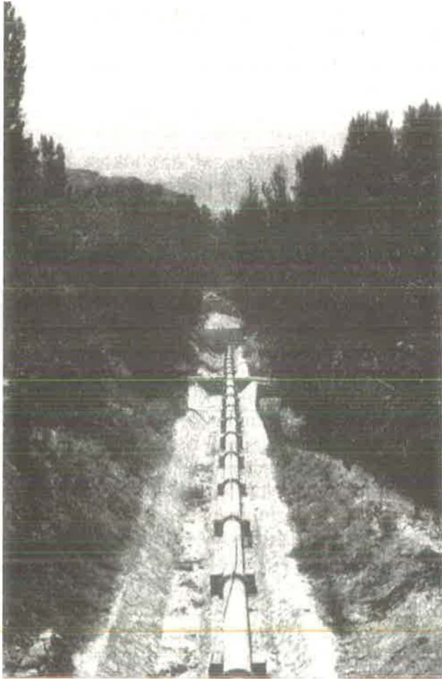
Elektrik santrali boru hattı.
